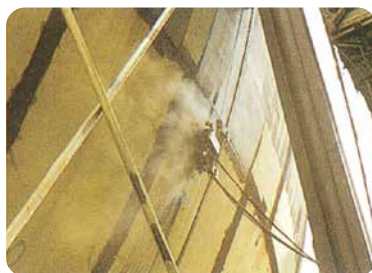
▶ 球形ガスタンク溶接線塗膜はくり
